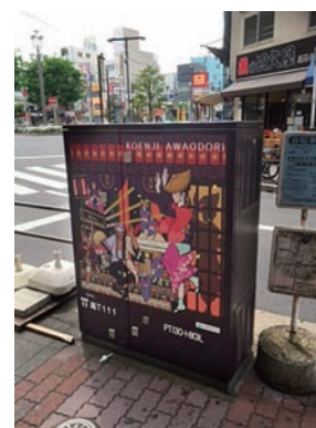
トランスボックスの活用事例 【写真は高円寺駅周辺】
